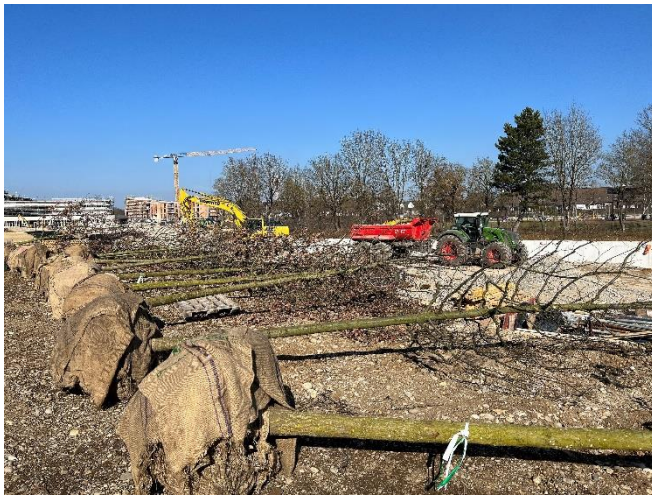
Auch rund um den Parksee werden neue Bäume gepflanzt. Foto: Kirchheim 2024 GmbH/Gerda Hausladen
